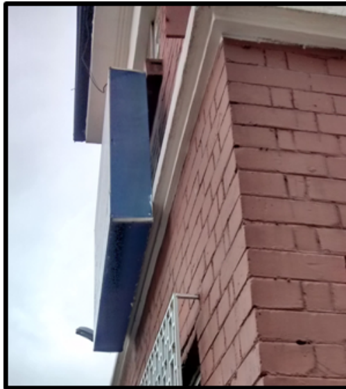
Foto No. 3 Aviso volado de fachada
